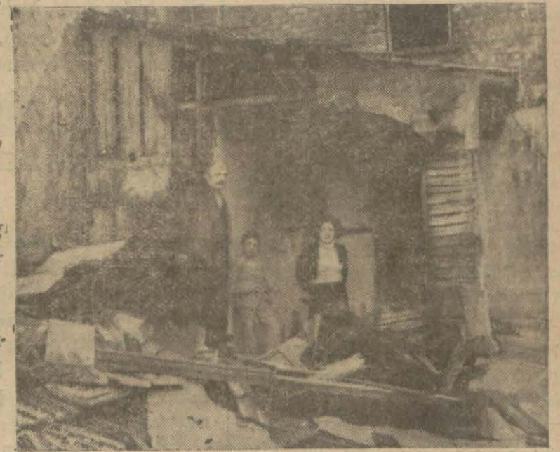
Yanan fabrika betonu, yangından sonra böyle bir şekil aldı, arkasında tutuşan binanın hali de budur
